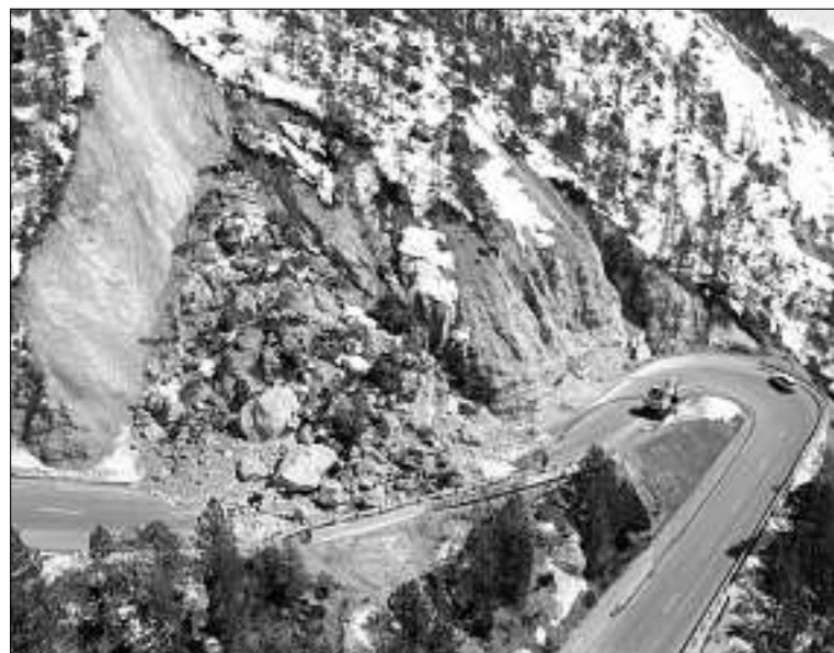
Felsbrocken und Schutt ergossen sich in der Nacht auf Montag auf die Ofenpassstrasse. (Foto Tiefbauamt Graubünden)
